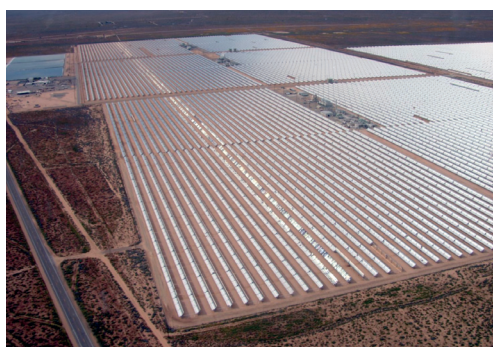
Uspořádání do parabolických koryt 4 elektrárny z komplexu SEGS, Mojave, USA
